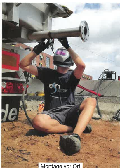
Montage vor Ort
